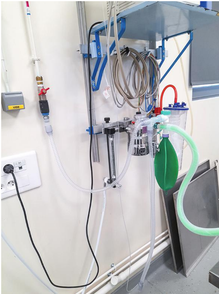
↑ FIGURE 5 Vue d'une vanne de réglage verrouillable et de la connexion.
