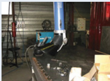
Fig. 35. Poste de soudage manuel.
