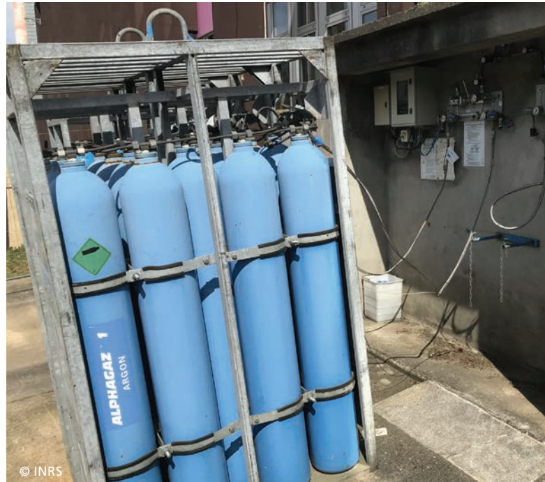
Figure 14. Cadre de bouteilles relié au réseau, avec câble de retenue
