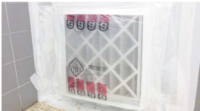
Visualisation de l'effet de gonflement (polyane gonflé) lié au maintien à l'arrêt de l'extracteur de secours, générant un risque grave de décolmatage des filtres dans la zone lors des vérifications avant le démarrage du chantier.
