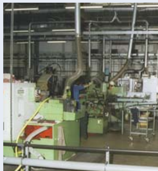
Photo 5. Vue générale de l'installation avec en premier plan le réseau d'alimentation et de récupération des fluides de coupe.
