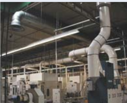
Photo 20. Vue générale d'un réseau de captage avec, en premier plan, le groupe de filtration. Un conduit d'arrivée d'air de compensation est également visible.
