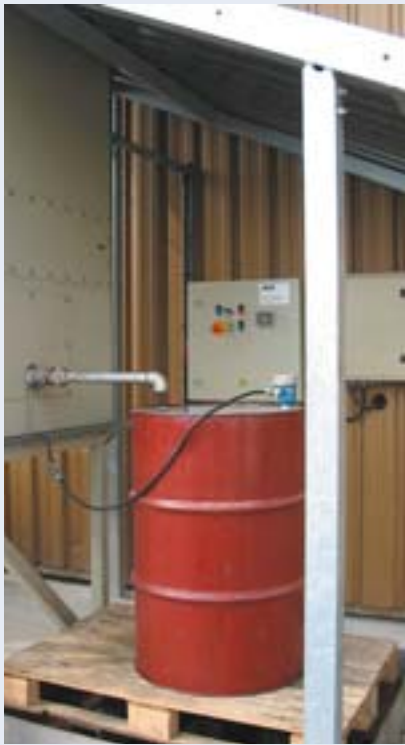
Photo 24. Le fluide est récupéré dans un fût situé sous le séparateur. Un contrôle du niveau permet d'éviter le débordement du fût et de prévoir son changement.
