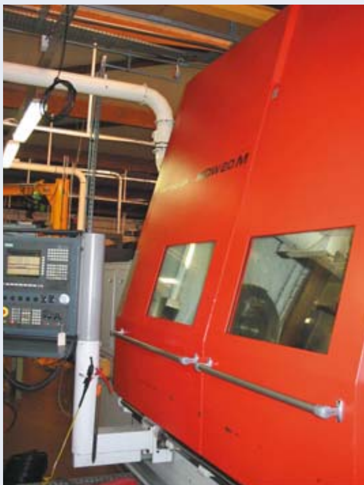
Photo 22. Les machines sont entièrement encoffrées (excepté un tour où une ouverture permanente est nécessaire pour le passage de la navette porte-outils). L'accès aux pièces s'effectue par des portes coulissantes.
