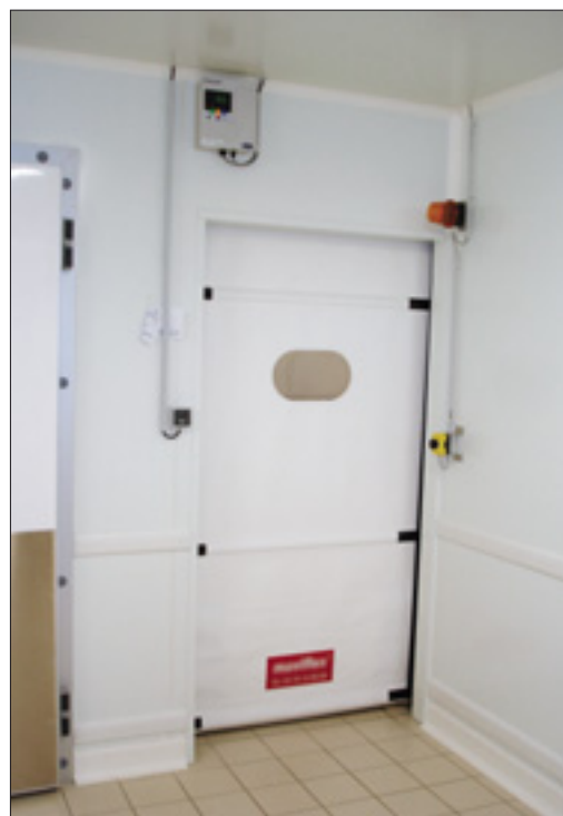
Porte à ouverture automatique avec hublot.
