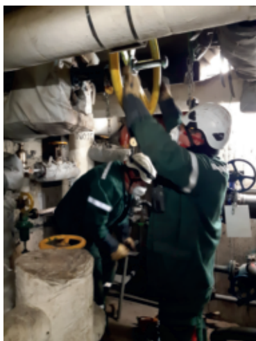
Figure 2 : Ouverture de la vanne de sectionnement.
