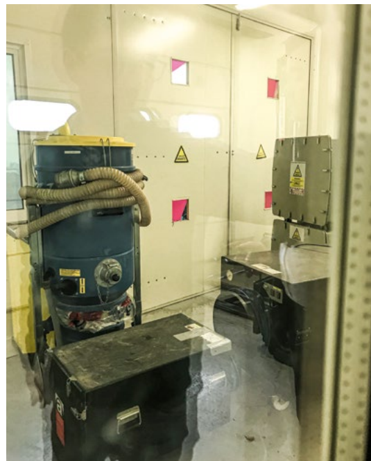
■ Figure 26. Gros matériel en attente dans l'écluse « entrée matériel » pour sa prise en charge dans l'unité de traitement. Les portes de l'écluse sont interverrouillables.
