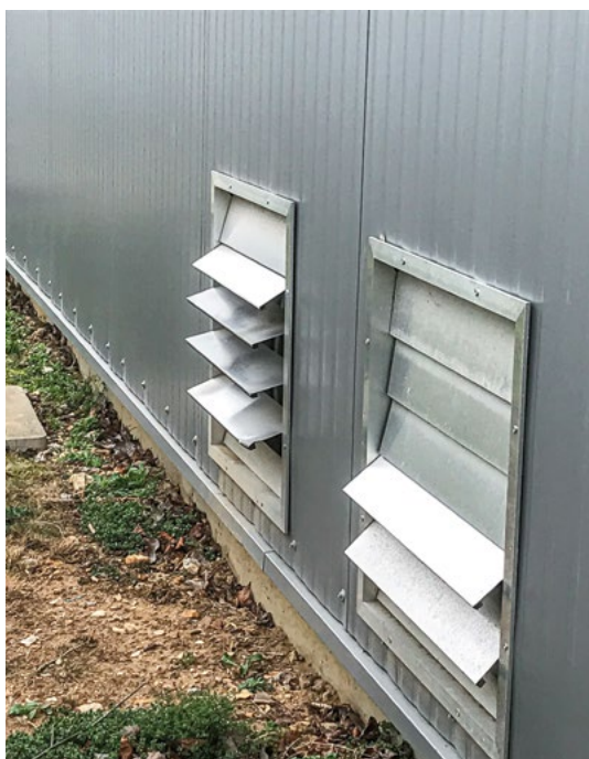
Figure 9. Rejet de l'air filtré par les extracteurs de classe H à l'extérieur du bâtiment
