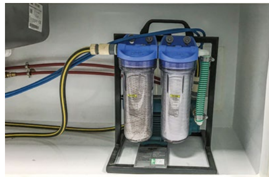
■ Figure 38. Unité de filtration des effluents à deux étages de filtration
