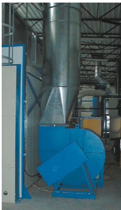
Ventilateur d'extraction d'une cabine de poudrage.
