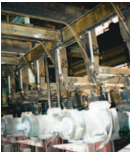
Photo 1. Cuve d'électrolyse pour l'étamage de tôles. Vue des amenées de courant.
