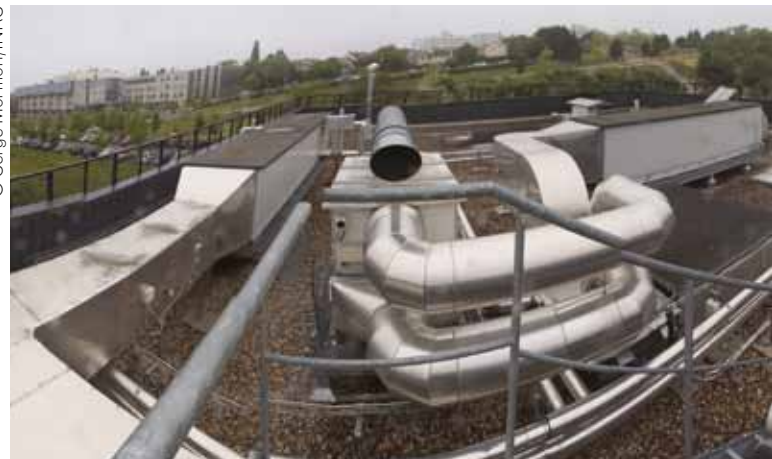
La centrale de traitement d'air avec récupérateur d'énergie
