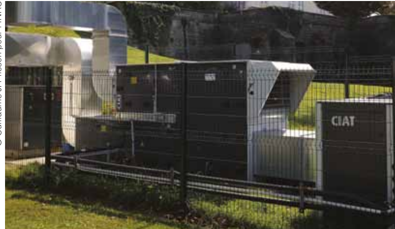
La centrale de traitement d'air
