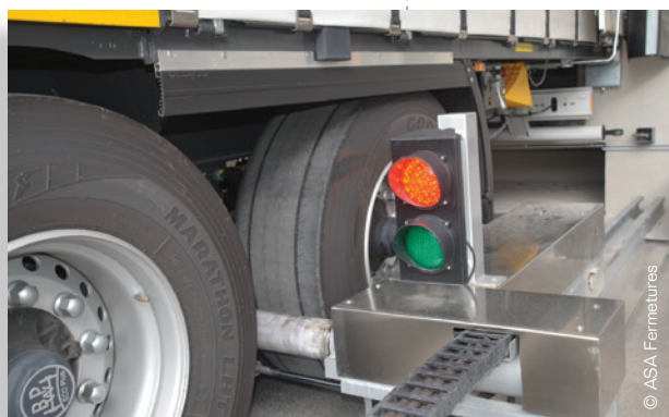
Bras hydraulique de traction assurant le calage du véhicule à quai
