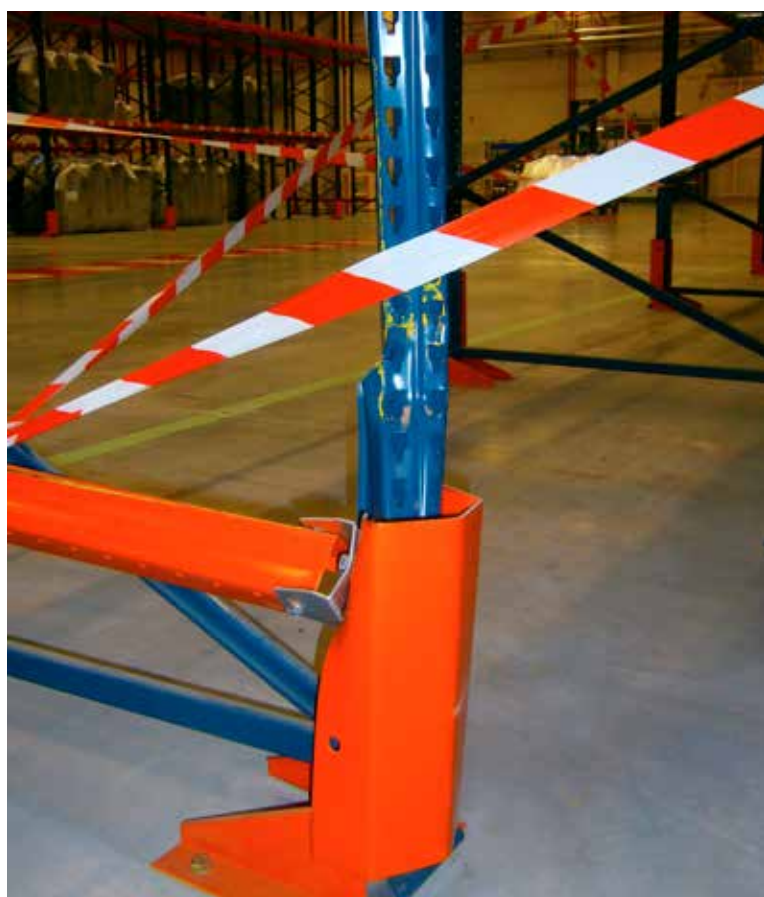
Poteau et sa protection détériorés, à remplacer
