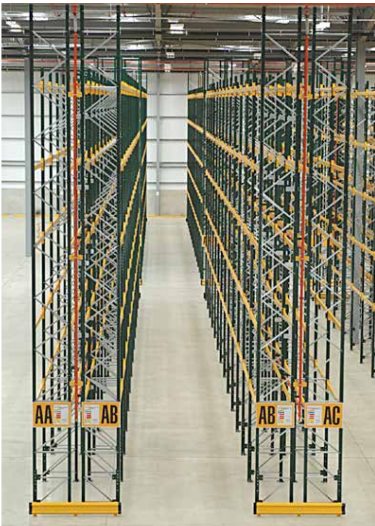
Installation de stockage à grande hauteur
