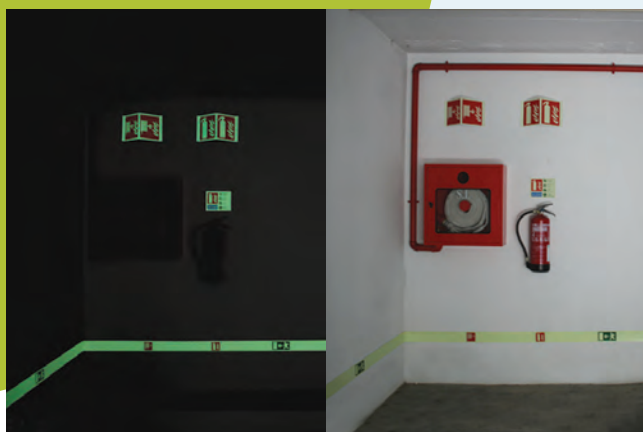
Exemple d'un couloir sans éclairage ou avec éclairage
