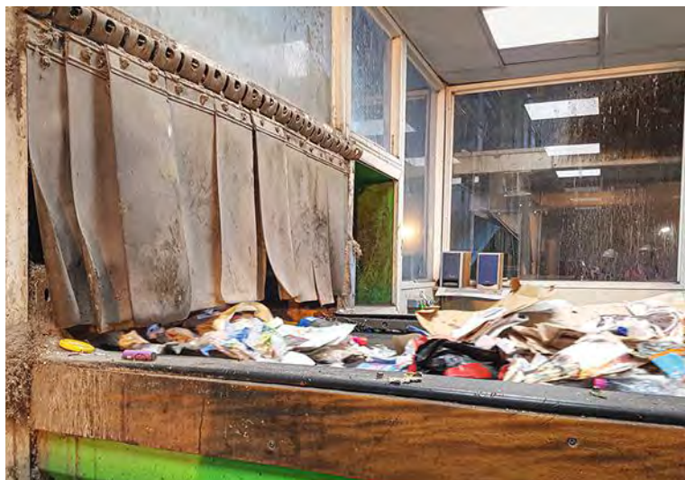
↑ PHOTO 2 Dépôts importants de poussières à l'intérieur de la cabine de tri. Lanières dégradées au niveau de l'entrée des déchets.
