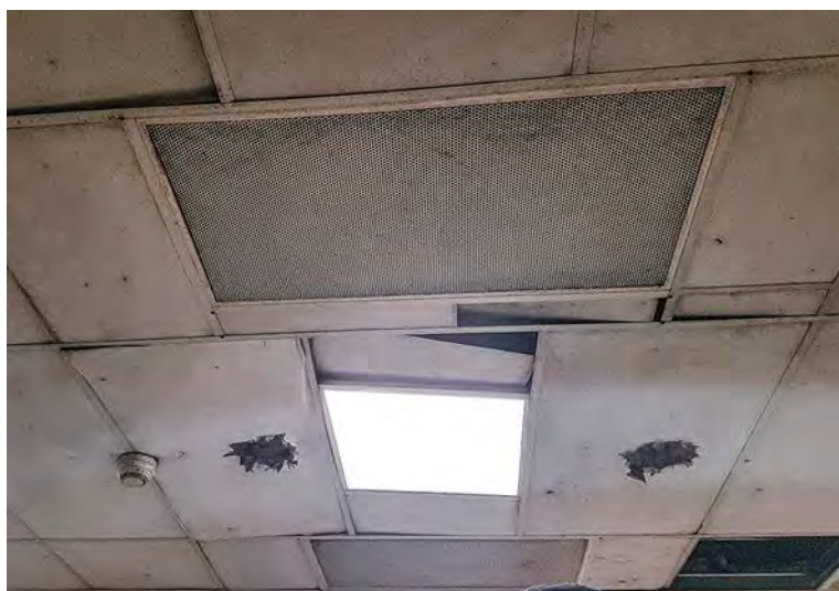
↑ PHOTO 1 Plafond de la cabine de tri : défaut d'ajustements et dégradations des plaques de faux-plafond.
