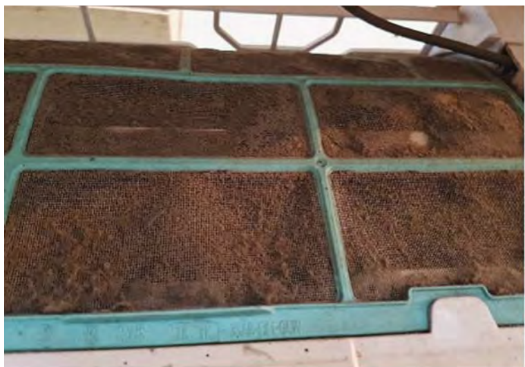
↑ PHOTO 3 Encrassement du filtre du système de traitement de l'air dans la cabine, lié à un défaut d'entretien.
