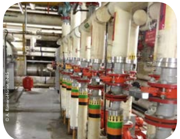
Chaufferie d'immeuble collectif
