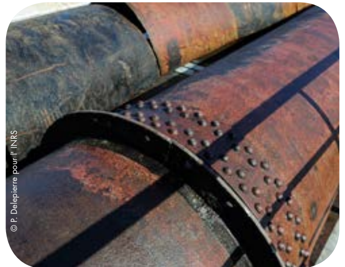
Conduite forcée revêtue de peinture bitumineuse amiantée
