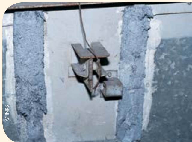
Sonde enrobée d'un mastic souple amianté
