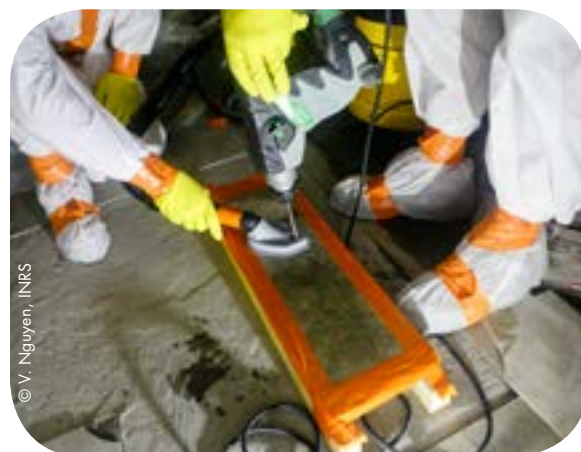
Système de captage à la source relié à un aspirateur THE
