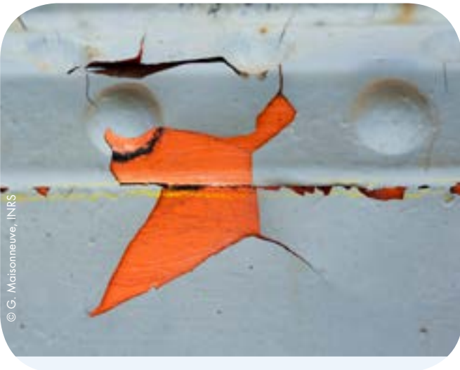
Peinture amiantée sur métal
