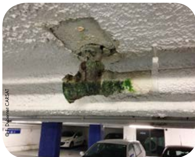
Enduit plâtre chargé à l'amiante
