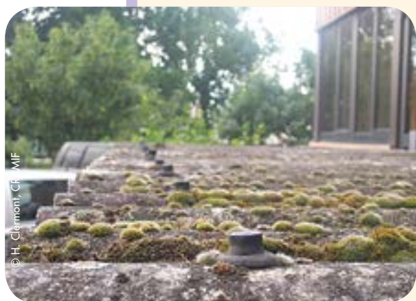
Toiture recouverte de mousses
