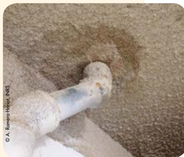
Canalisation en amiante ciment fuyarde
