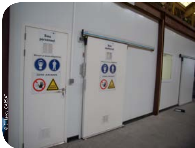
Salle « blanche » pour l'entretien des équipements contaminés
