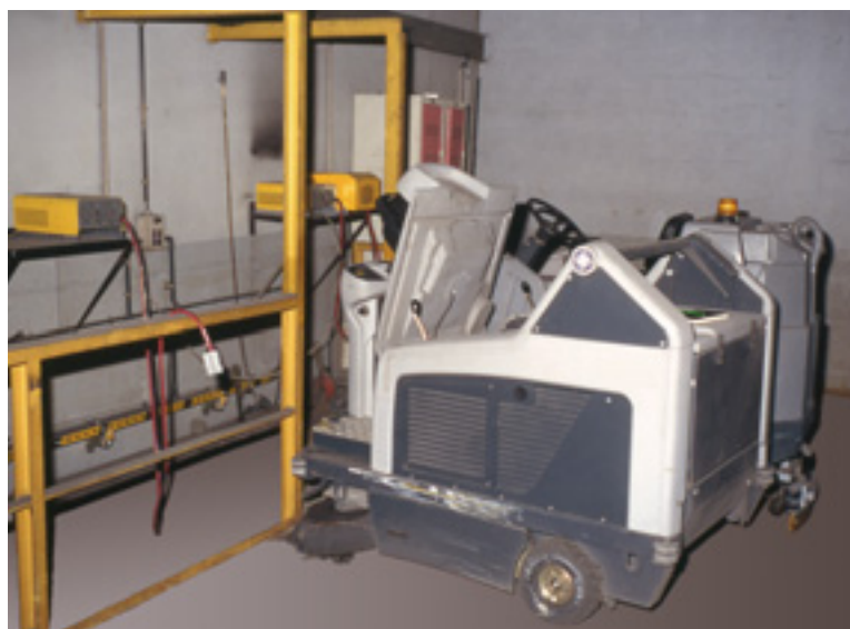
43. Local de recharge des batteries
