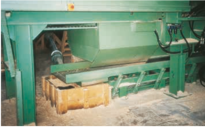
Figure 10. Captage des déchets par trémie. Évacuation par tapis vibreur
