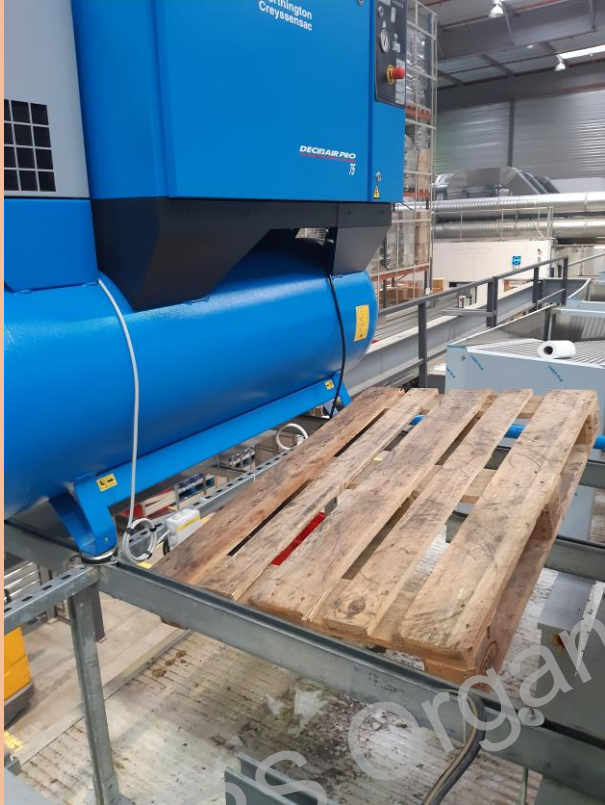
Avant du compresseur
