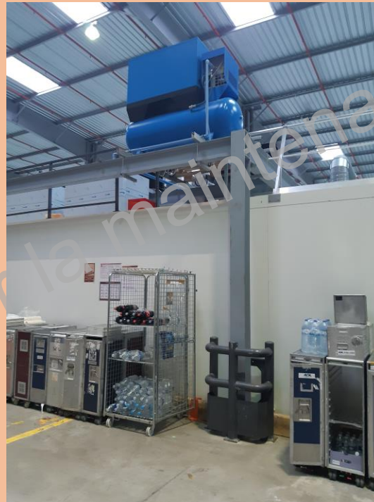
Arrière du compresseur
